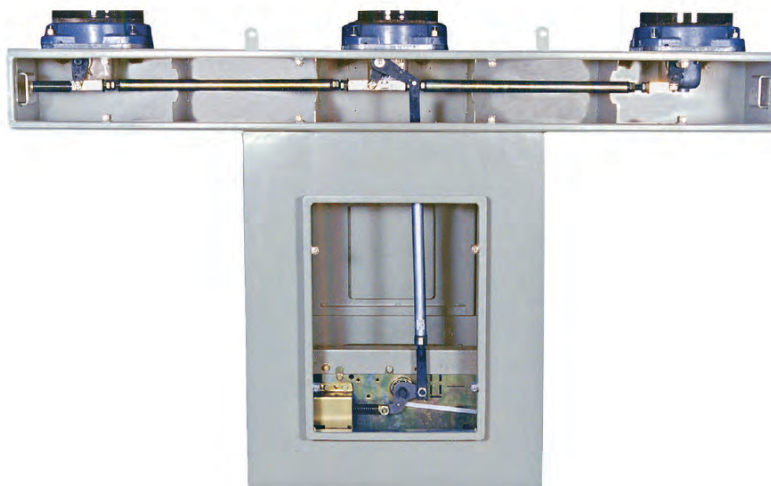
04 Вид шафи приводу ззаду з демонтованою задньою кришкою
